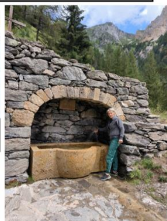
Juin 2023 : La fontaine de la source des Vernettes rénovée avec son nouveau bassin
